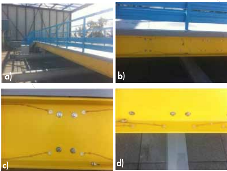
Passerelle composite instrumentée par patches ultrasonores et fibres optiques, a) vue d'ensemble, b) localisation de la zone instrumentée par patches ultrasonores d'un assemblage et d'un profilé pultrudé, c) instrumentation d'un assemblage, d) instrumentation d'un profilé pultrudé
